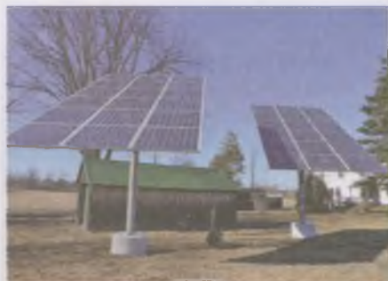
9. ábra. Magánterületen felállított félvezető napelemek
